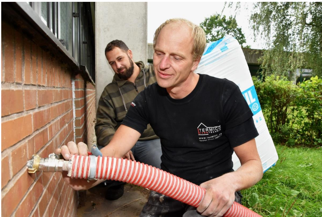
Jörn Renken (v.) und Lucas Peth von der Firma Termico aus Brake blasen an der Oberschule Bookholzberg Mineralwolle in die Hohlwände. Ziel ist die Einsparung von CO 2 und Energiekosten. Foto: Gemeinde Ganderkesee / Hauke Gruhn
